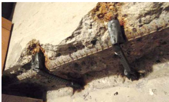
写真1 集合住宅梁の欠損改善計画・監理
