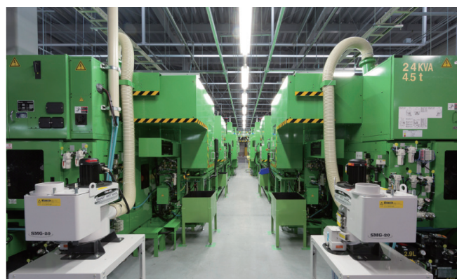
工場棟内部 生産設備
