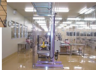
米子市菓子製造工場 包装搬出ライン
