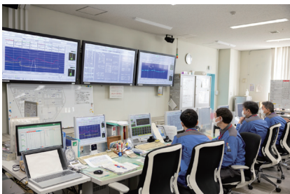
浄水場運転監視
