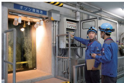
設備保全管理
