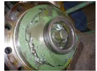
性能が低下したポンプ開放時の写真
